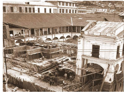
Figura 6. Palacio de Gobierno en proceso de reconstrucción. 1956-1960. S.A. (s.f.). El Palacio de Carondelet, sede del gobierno ecuatoriano. Recuperado el 11 de mayo de 2020, de El cofresito: https://elcofresito.blogspot.com/2017/11/el-palacio-de-carondelet-sede-del.html
