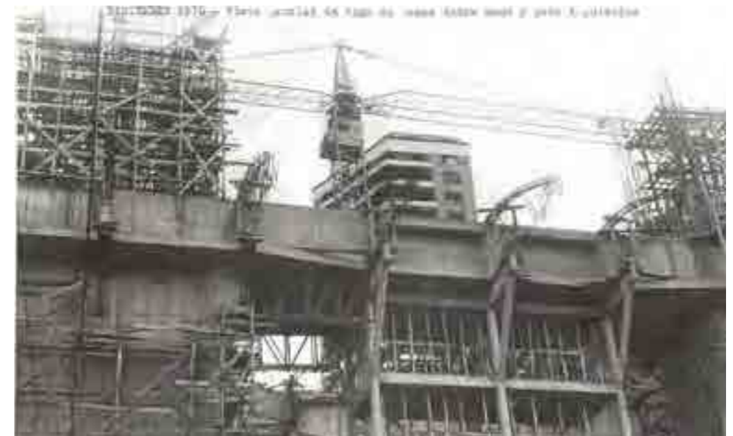
Figura 5. Los encofrados del hormigón armado de la biblioteca. En el acápite de la fotografía, las partes de la estructura se denominan "patas" y "barriga", como si de un ser vivo.
